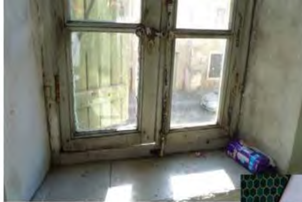
Fenêtre non étanche
