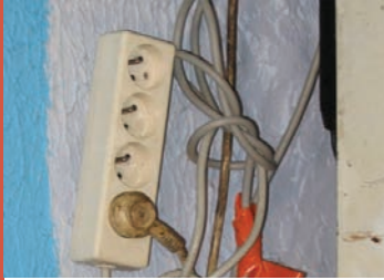
Installation électrique dangereuse
