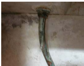
Absence de siphon
