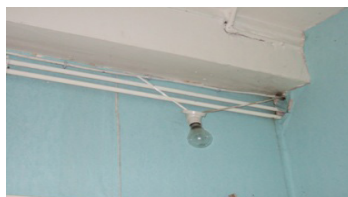
Eclairage insuffisant et dangereux
