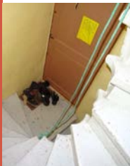
Absence de dispositifs de retenue des personnes
