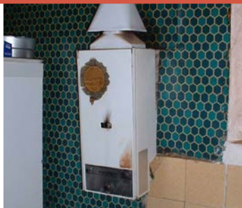
Absence de dispositif d'évacuation des gaz brûlés
