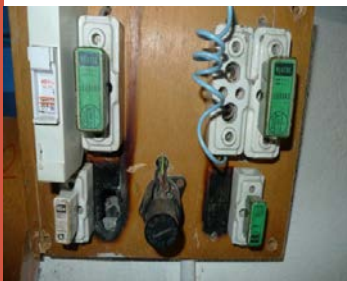
Branchements d'électricité vétustes
