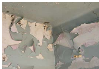
Peinture écaillée contenant du plomb
