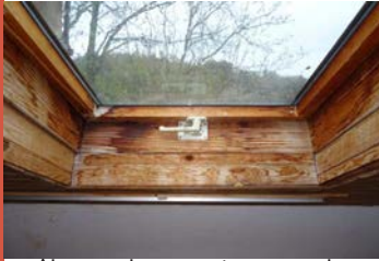
Absence de protection contre les infiltrations d'eau
